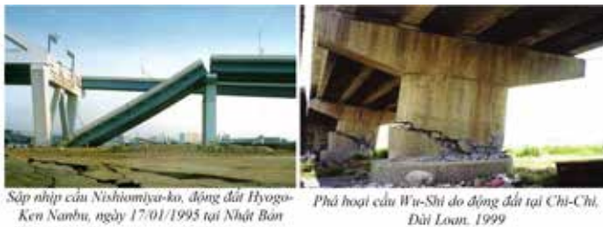
Hình 1. Công trình cầu bị phá hoại do động đất.
