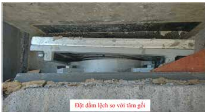
Hình 6. Lỗi sai kỹ thuật trong quá trình lắp đặt gối cầu.
