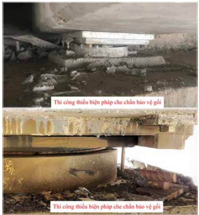
Hình 7. Lỗi không thực hiện đủ quy trình thi công theo quy định.
