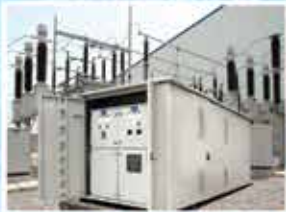
Trạm Kios Kiosk substation
