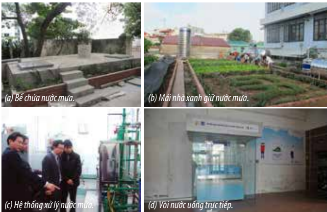
Hình 1. Hệ thống thu gom nước mưa lắp đặt tại Trường Đại học Xây dựng Hà Nội.
