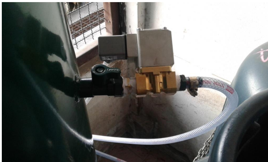
รูปที่ ๒.๑๐ การเชื่อมต่อถังอัดก๊าซชีวภาพเข้ากับปั๊มอัดก๊าซชีวภาพด้วยสายถักพีซีซีขนาด ๓ หุน
